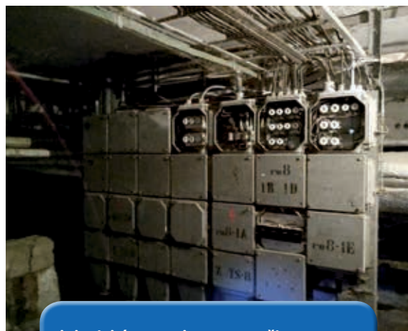
Elektrické rozvody UnLP Košice (Zdroj: Autor)
